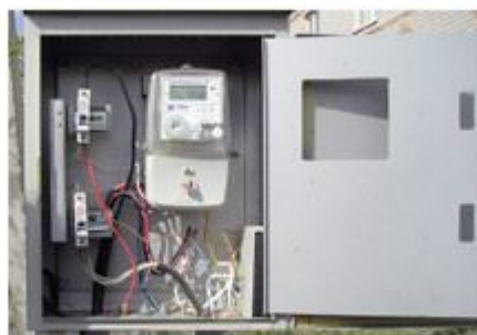
Фото 2. Внутренний вид ШВУ
