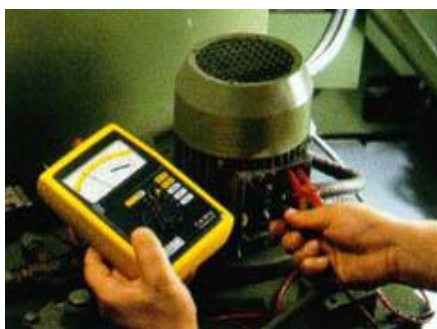
Тестирование изоляции на обмотках электромотора
