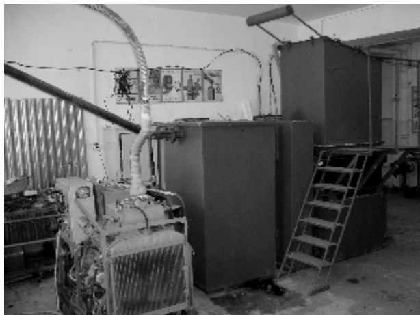
Фотография 1. Общий вид газогенераторной установки
