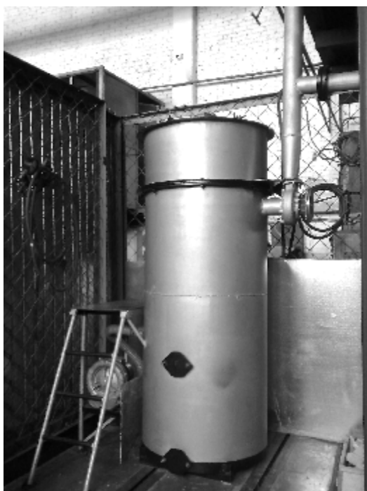
Фотография. Газогенератор мощностью 100 кВт, созданный в Тихоокеанском государственном университете
